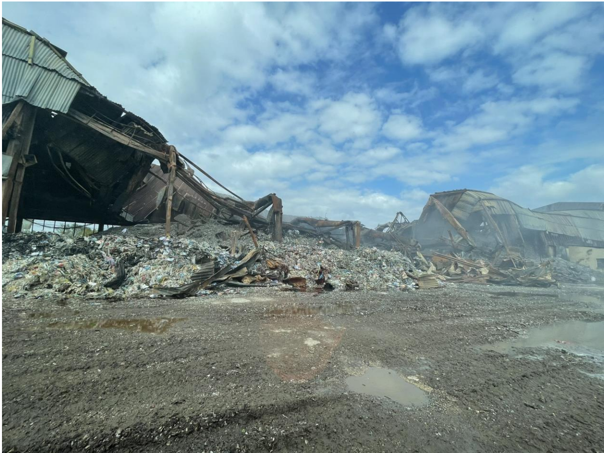
Trebišov - požiar haly Enwoy Gas, s.r.o.
